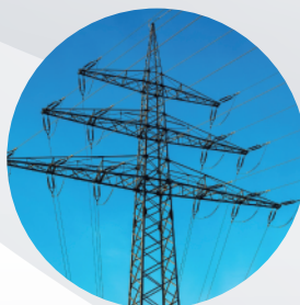
Power Grid / 电网
